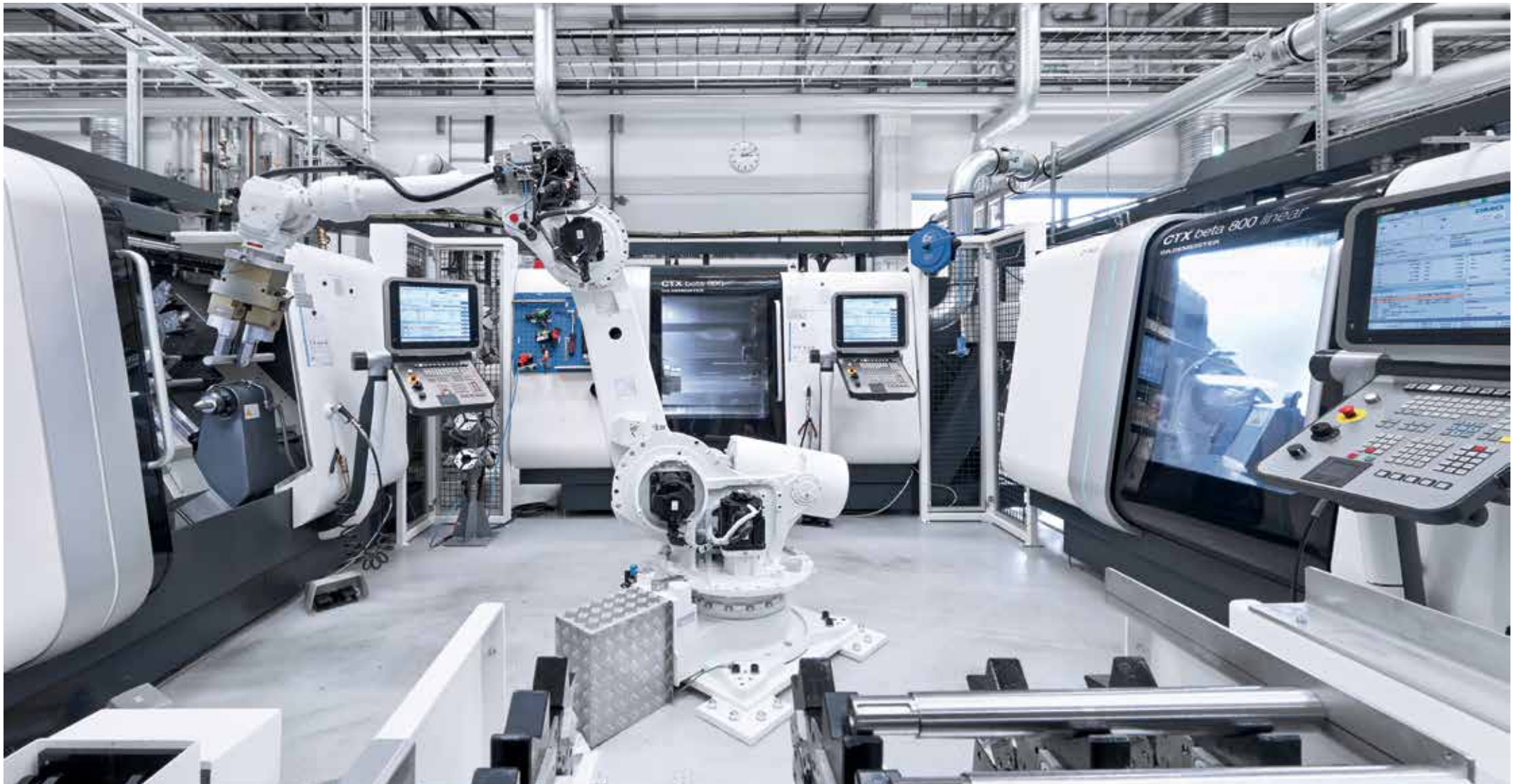
A finales del 2013 DMG MORI Systems ha instalado una célula de fabricación compuesta de 2 CTX beta 800 y una CTX beta 800 linear en la empresa Xylem.
